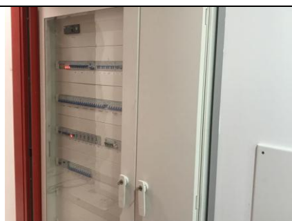
Quadro elettrico generale Centro Anziani e parti comuni
