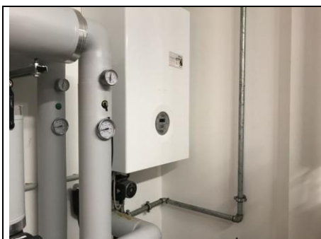
Centrale termica piano interrato
