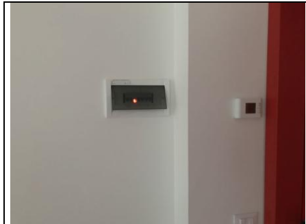
Esempio interruttore e quadro elettrico di zona.
