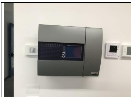
Centralina antincendio piano terra
