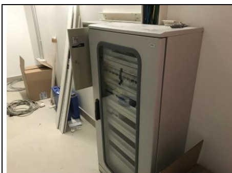
Quadro elettrico generale ASUI-UD
