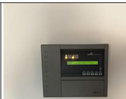
Centralina antincendio secondo piano
