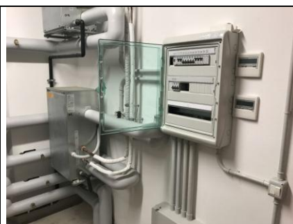
Quadro elettrico centrale termica
