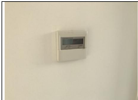
Esempio centralina climatizzazione
