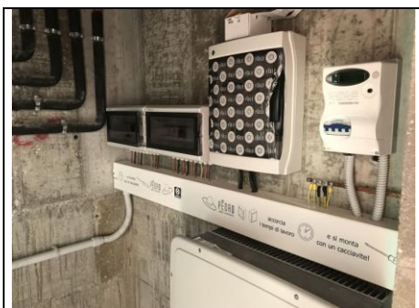
Quadro elettrico fotovoltaico
